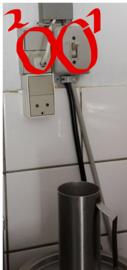
El til kaffemaskiner tilsluttes/ afbrydes på afbryder 1. Afbryder 2, skal ikke røres !!
