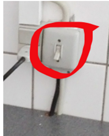
Afbryder opvaskemaskine (står altid tændt)
